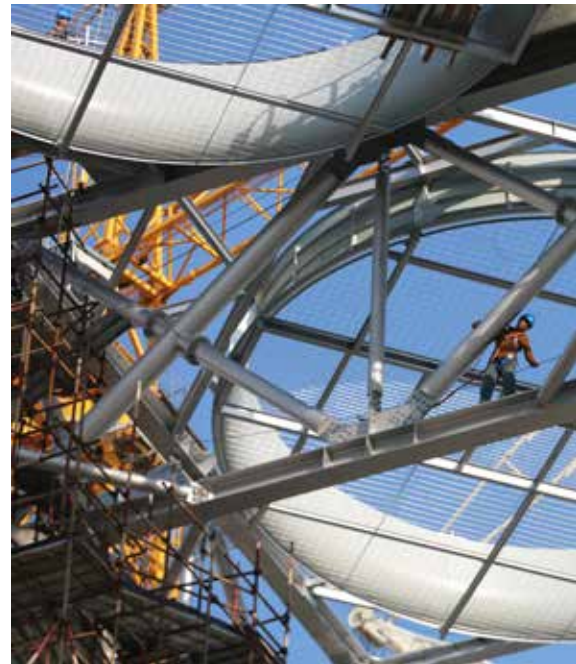
工作人员搭建空冷岛时，在约零下30℃、高空70m的地方作业的照片
