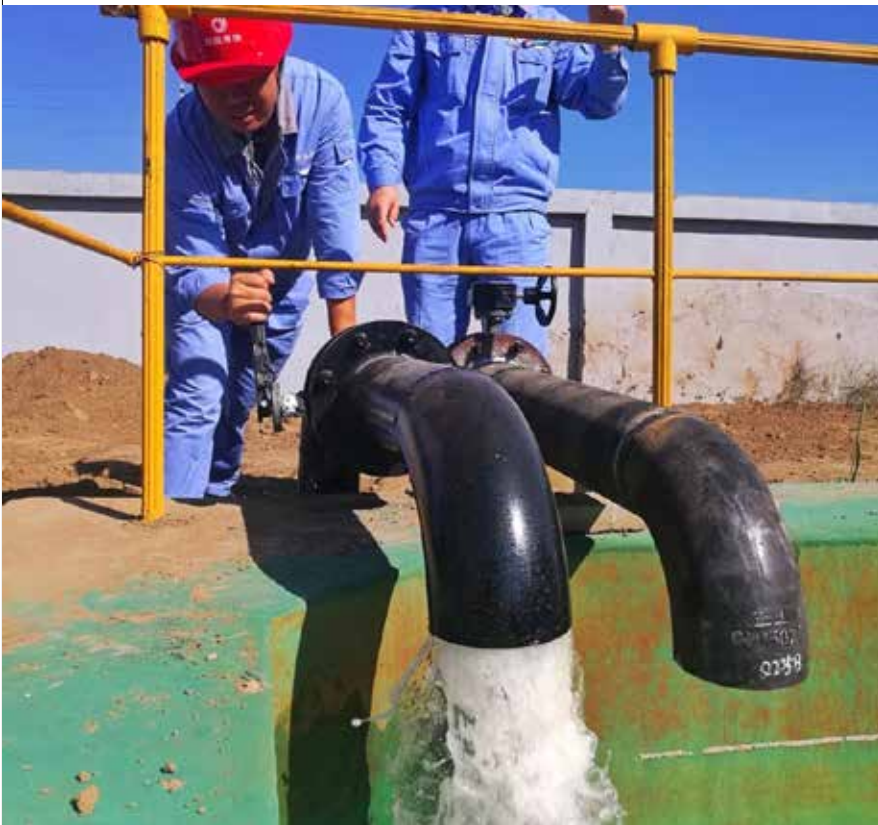
中水源源不断的引入生产现场
