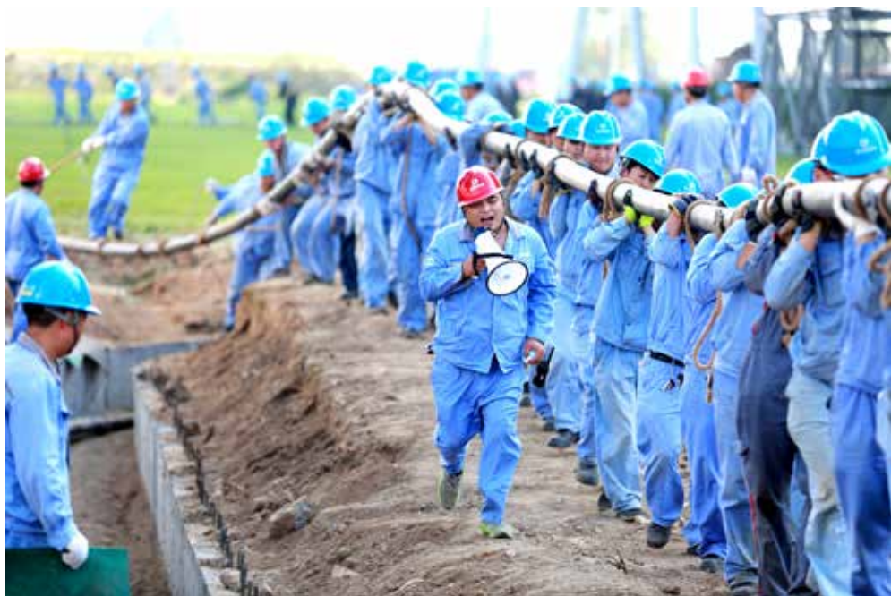
工作人员在引中水入厂时作业的照片
